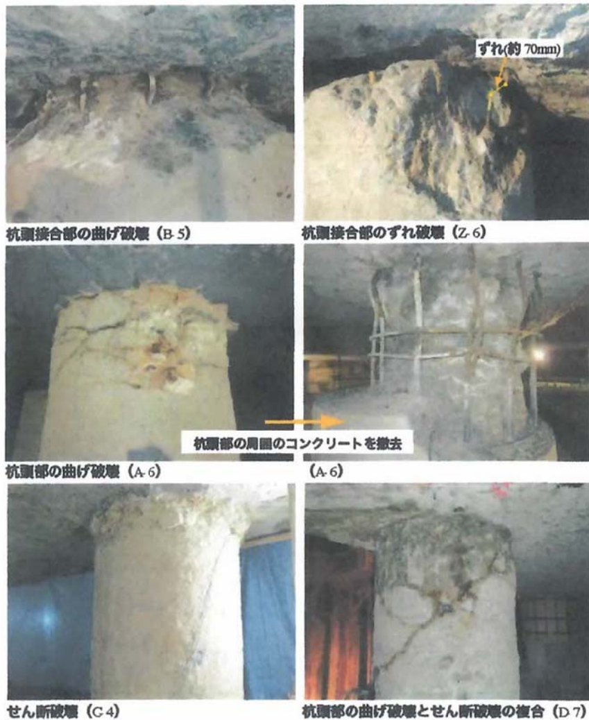
写真 1 観察された杭の破壊パターン(例)
