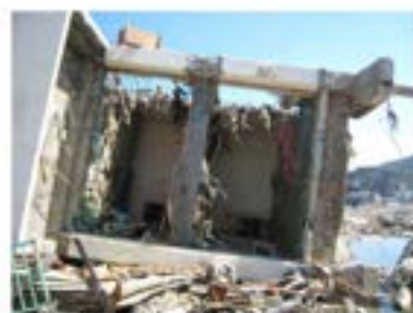
写真3 建物正面（有開口外壁の破損）
