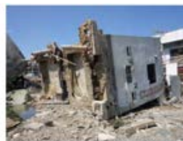
写真2 建物直面（杭の破損）
