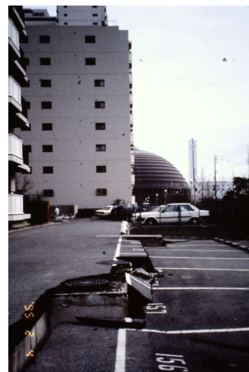
写真-8 段差の例
