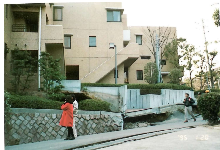
写真-1 建物下の空洞と道路の段差 道路と石垣が陥没したため、 建物の下に空洞ができ道路 に段差が生じた。
