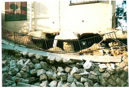
写真-2 建物下の空洞 地盤が陥没したため、建物 の下に空洞ができた。 杭頭が見えている。
