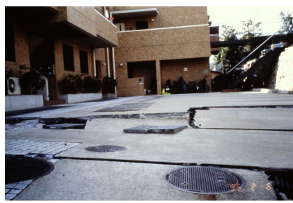
写真-2 内庭コンクリートの段差
