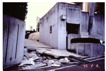
写真-3 アプローチの破壊状況
