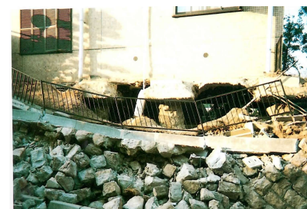
写真-2 建物の下部の空洞 地盤が陥没したため、建物の下に空洞ができた。杭頭が見えている。
