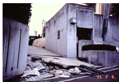
写真-3 アプローチの破壊状況
