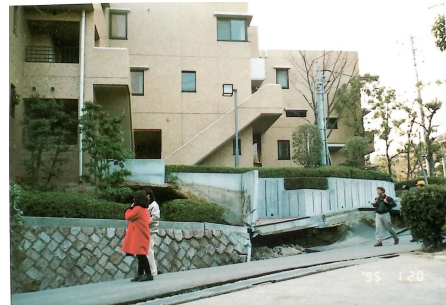
写真-1 建物下の空洞と道路の段差 道路と石垣が陥没したため、建物の下に空洞ができた道路に段差が生じた。
