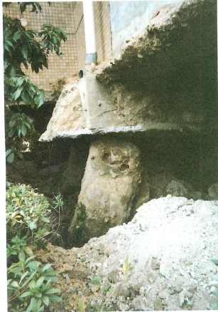
写真-3 杭頭接合部での出げ破壊
