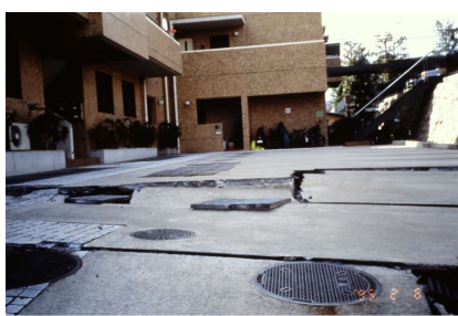
写真-2 内庭コンクリートの段差
